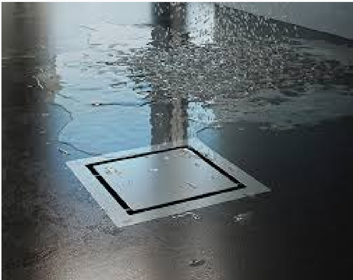
Aplikasi grease trap, Aplikasi floor drain.
