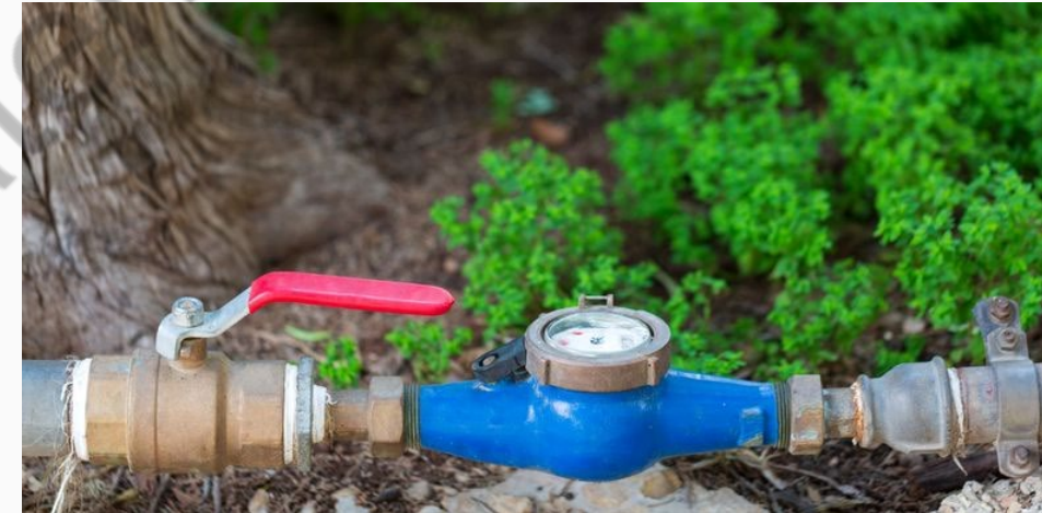
Meteran pada sumber air primer
